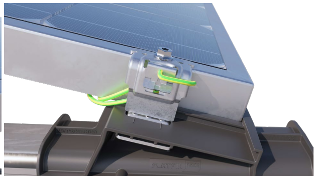
Figuur 9: Aardingsklem gemonteerd
